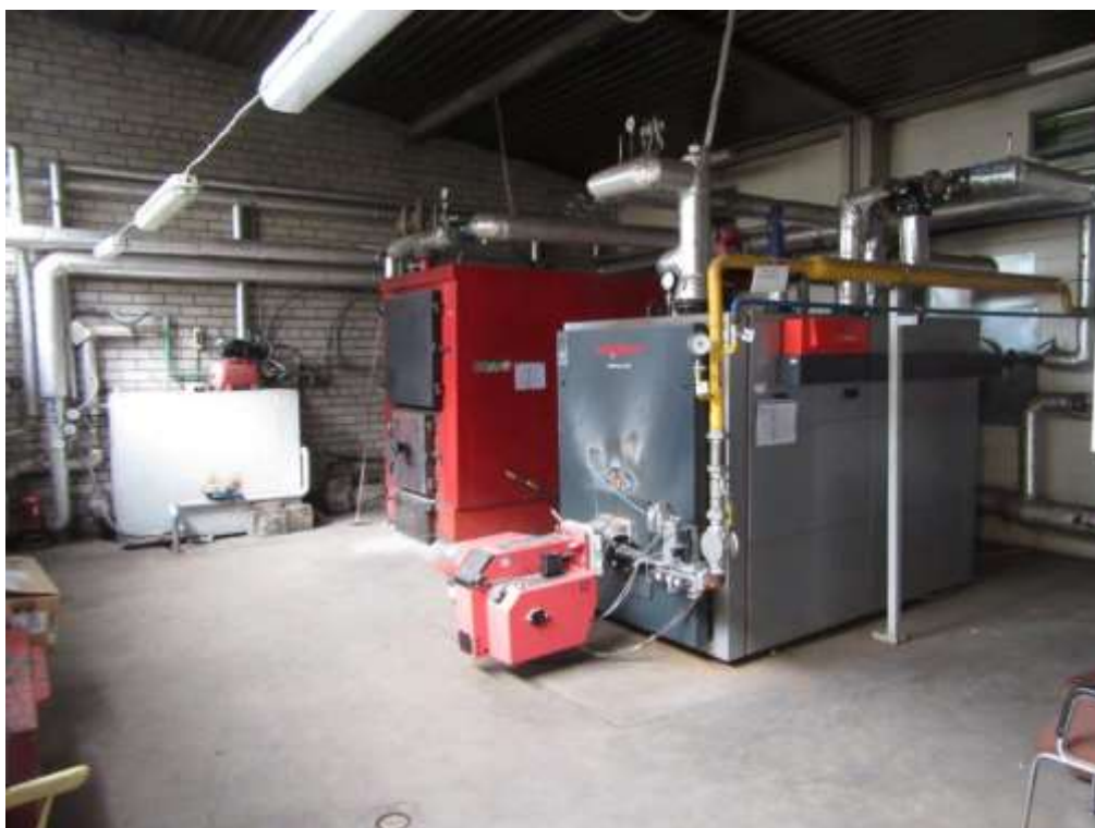
26.attēls. Katlu mājas aprīkojums
