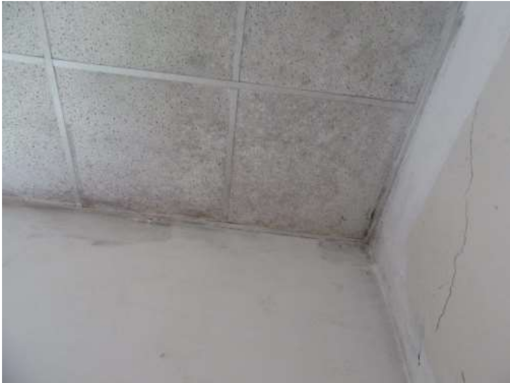
13.attēls: Virtuves bloka iekštelpas (ēdamzāle- bojātas sienas)
