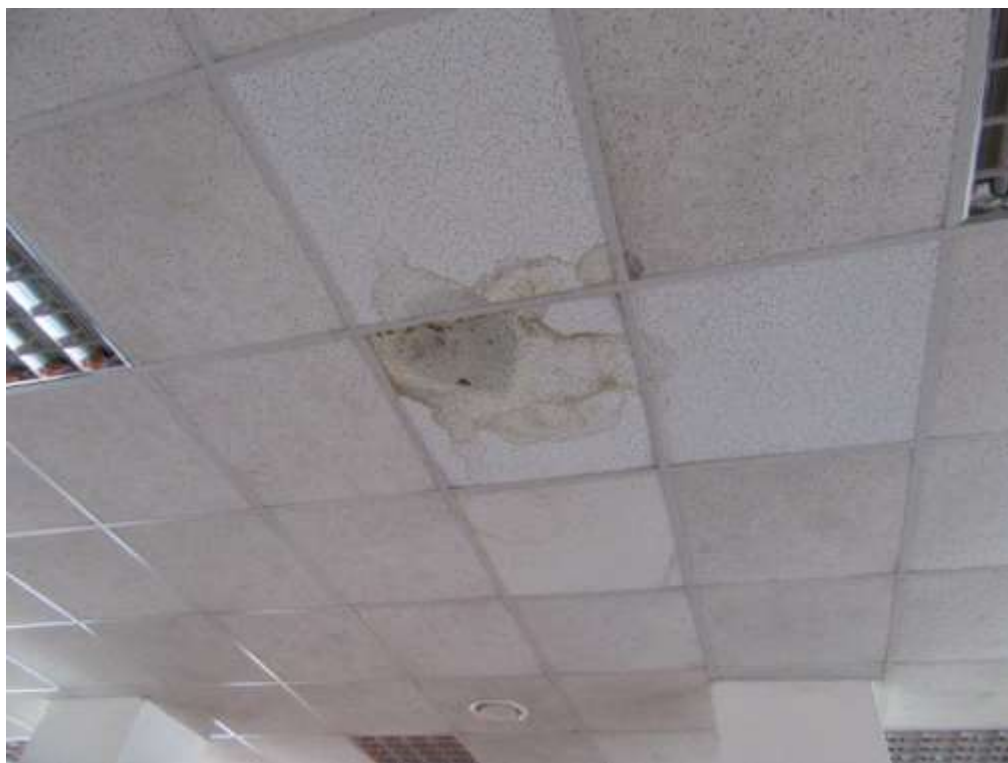
14.attēls: Virtuves bloka iekštelpas (ēdamzāle- bojātie griesti)
